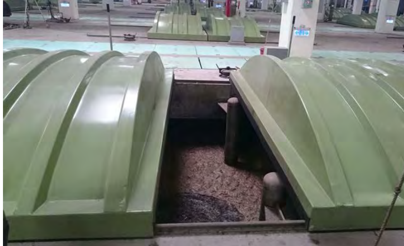
圖二 迪化汙水處理廠 耗氧池
