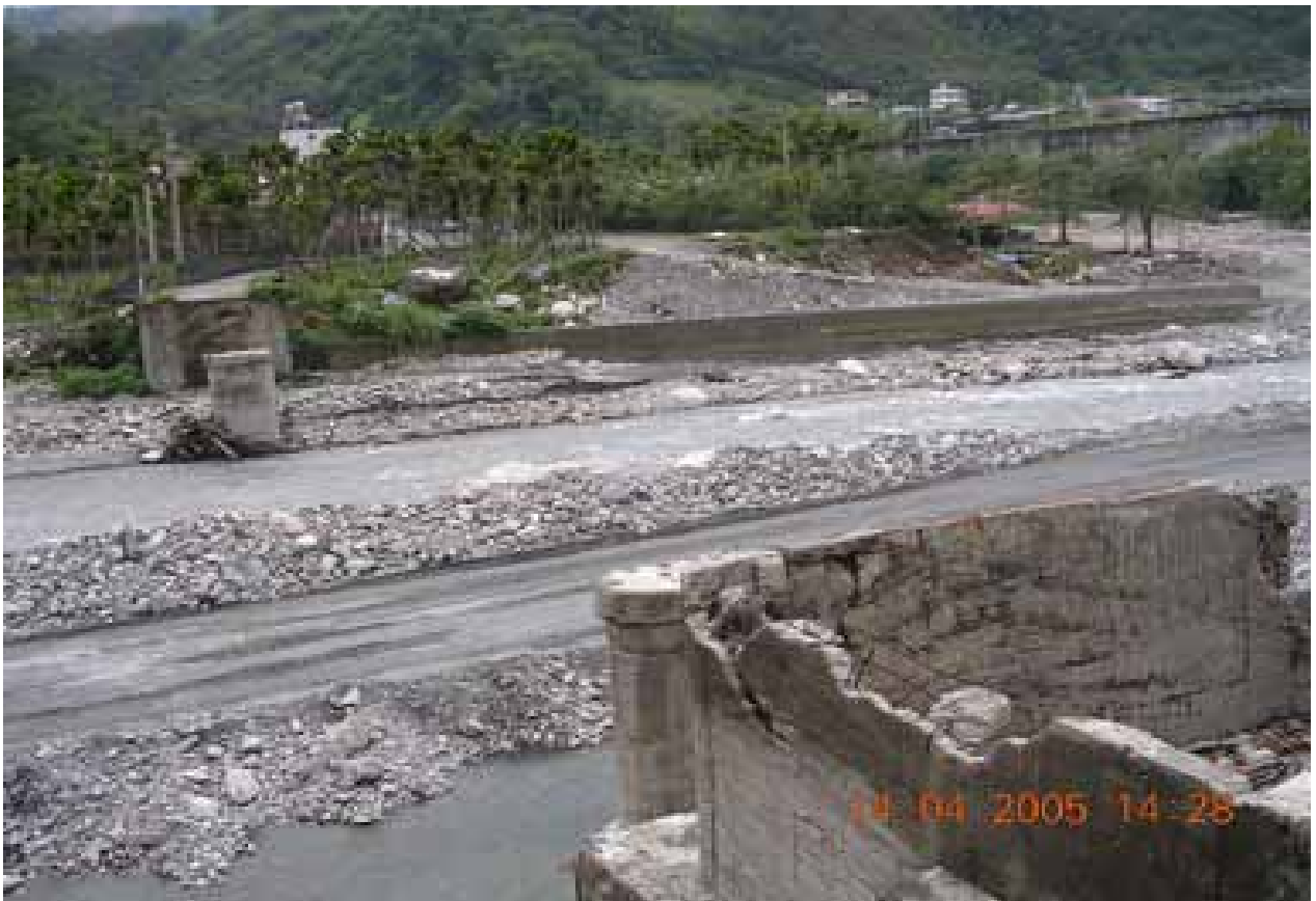
圖十三 沖毀的裡冷橋橋墩
