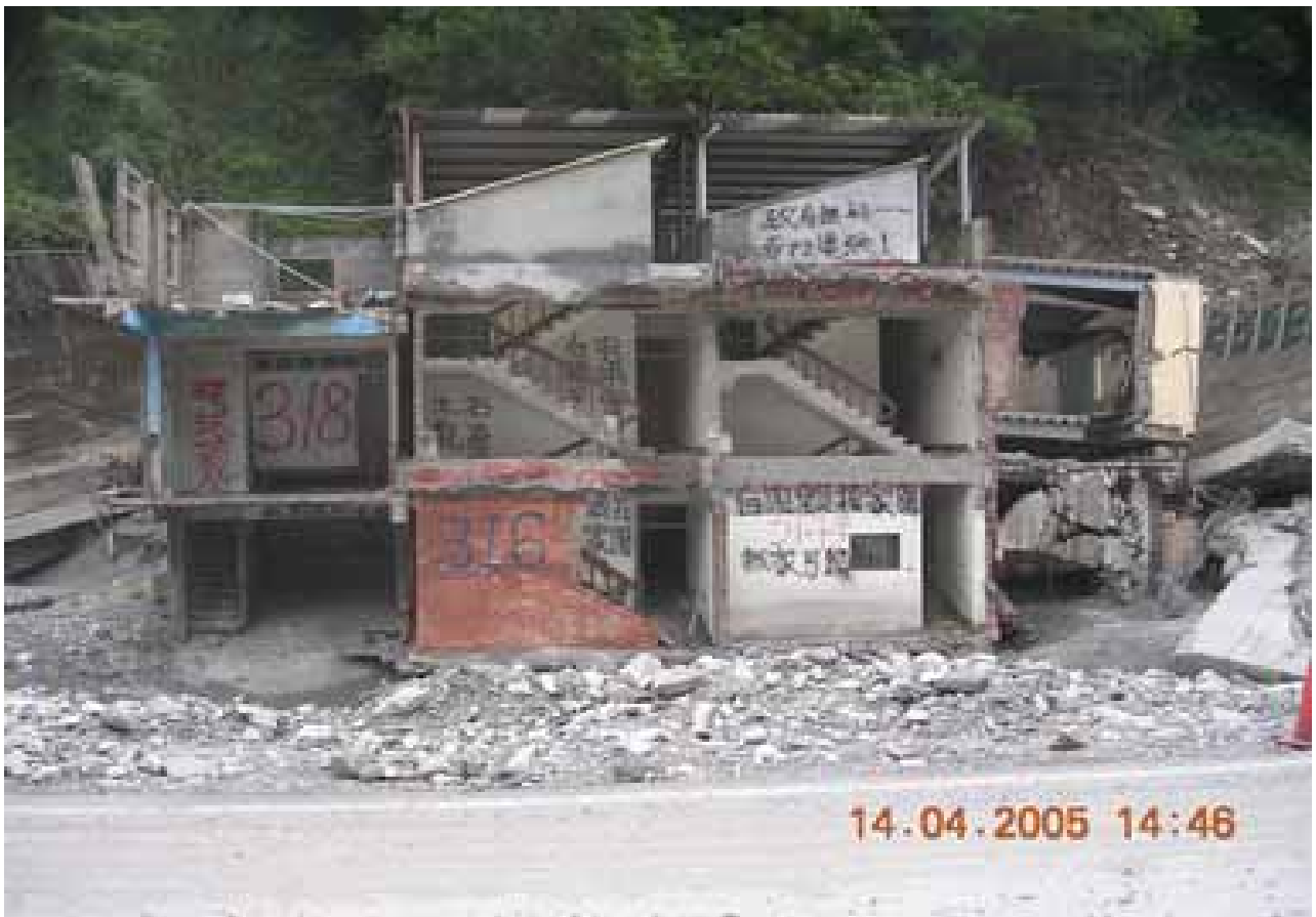
圖十四 台 8 線公路旁被土石流摧殘的民房
