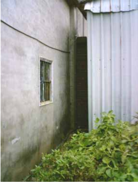
桃園縣大園鄉五權村三面牆（照片 9-1）
