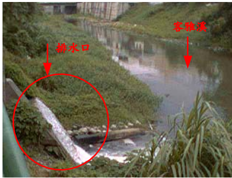
南大路634巷之排水口
