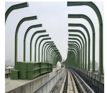
圖 4-1 捷運隔音牆(本圖
