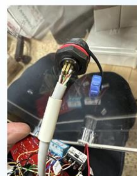
▲電線接到防水接頭
