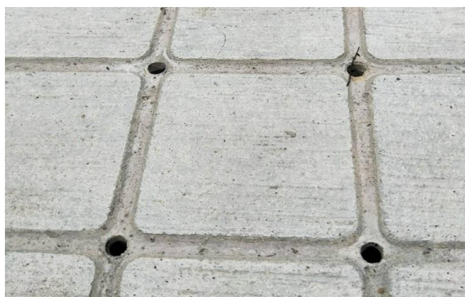
圖九：JW 工法路面上的孔洞（自由時報，2019）
