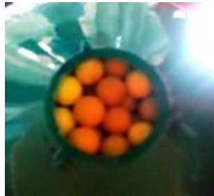
5-1-2 漏斗口阻塞的實際照片
