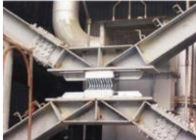
圖A2 位移型阻尼器 (照片取自建築世界網站)
