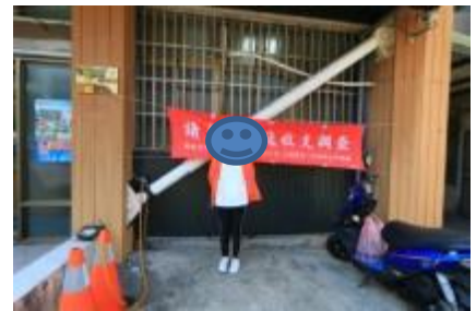
圖A3 速度型阻尼器 (桃園市新坡派出所)
