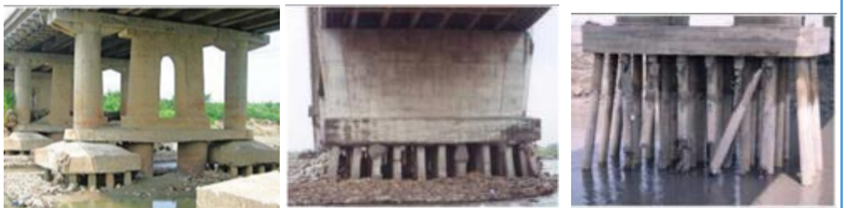
圖3 橋墩劣化程度比較圖
