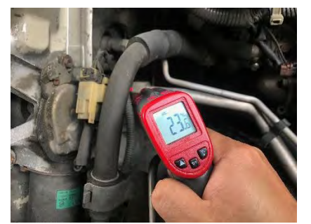
怠速中冷氣管 23.6°C
