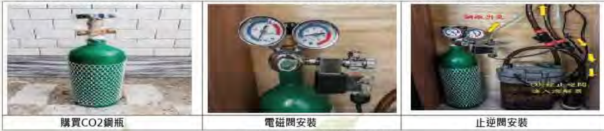
▲圖12 CO2濃度測定設備
