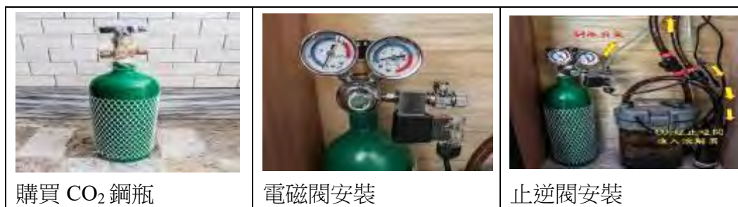
圖 12. CO 2 濃度測定設備
