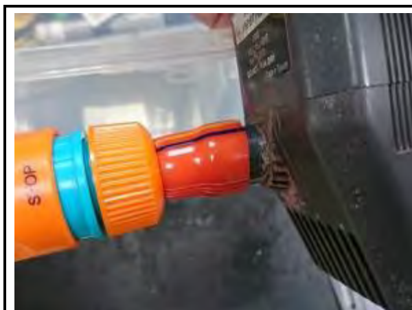
沉水馬達排水口加裝快速接頭。
