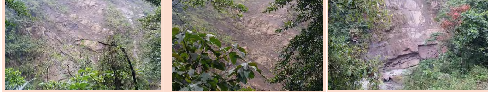
台18號公路36K的大崩塌約50公尺高 砂頁岩互層的崩塌面一角，持續崩塌 大崩塌面的逆向坡上，有墜落的痕跡
