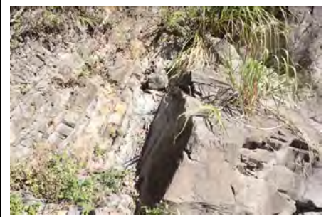
圖 1-36: 塊狀砂岩的左側砂頁岩，被侵蝕一大片。
