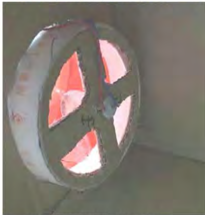
抽氣箱左側出口排風扇
