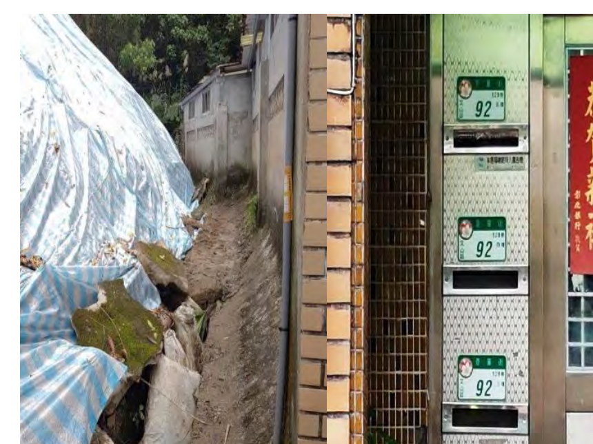
圖 18 景華街崩塌現場
