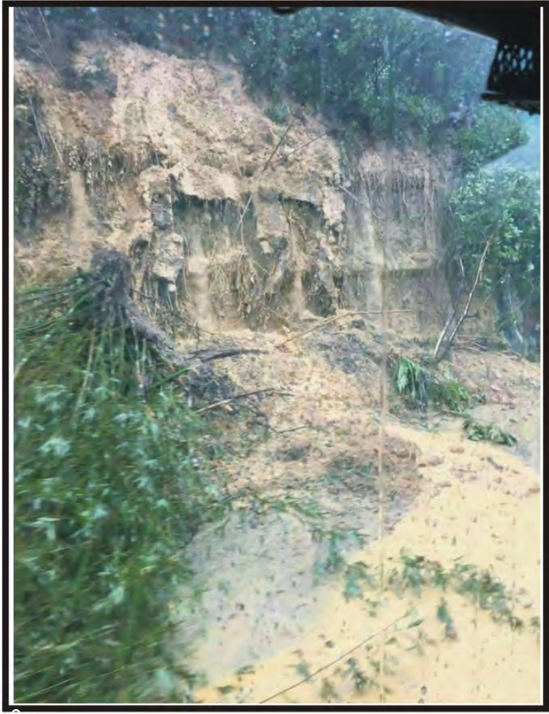
圖六(c)2016/10/20梳榔腳附近地區發生山崩，土石漫布102縣道的即時現況。
