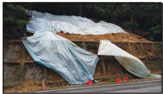
圖六(b)2016/11/26梳榔腳附近地區因連日下雨，同一地點再度發生山崩的現象。
