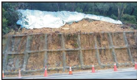
圖六(a)2016/10/20 梳榔腳附近地區因強雨侵蝕發生山崩，部分落石已清理的現象。
