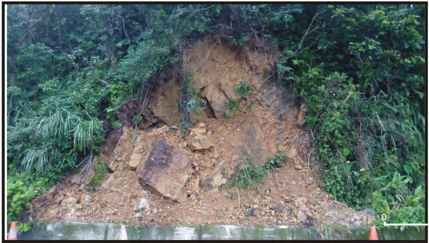
圖六(d)金光路上，受到連日豪大雨侵蝕作用下，產生山崩的現象。
