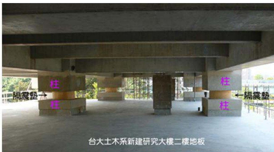
圖二十九 台大土木系新建研究大樓在二樓裝置隔震墊，隔絕經由基礎及一樓上傳的地盤震動(洪如江攝)
