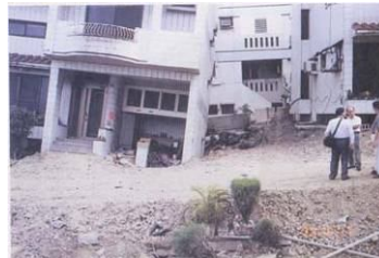
圖 3-2 土壤液化災害-房屋傾斜
