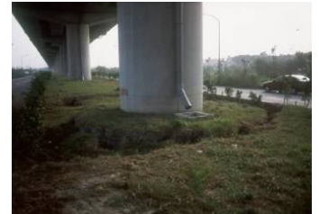
圖 3-3 土壤液化災害-橋墩陷落
