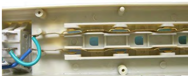
圖 4-6 原延長線內部線路
