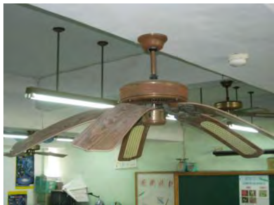
圖 5 吊扇扇葉變形
