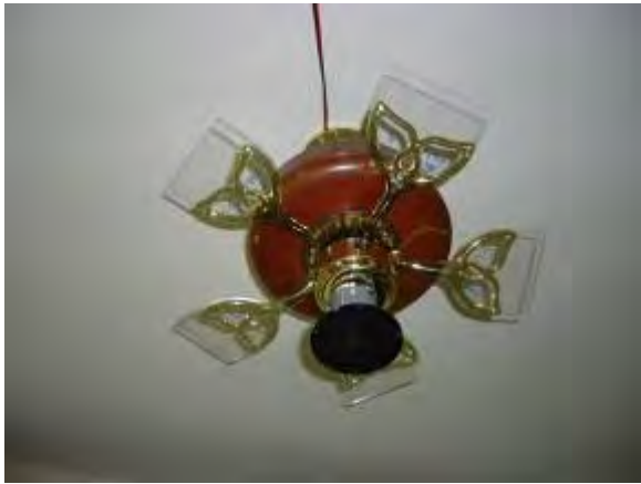
圖 61 吊扇電源另外拉出
