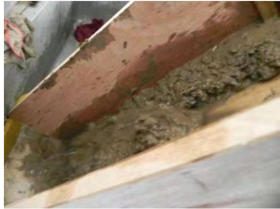
黃色砂土大量崩落
