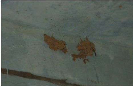
照片 7 <HALF=損壞大於一半
