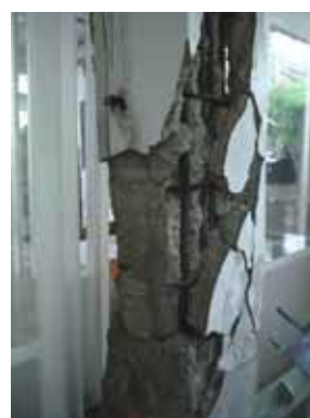
圖 5-10 柱子水泥裂開情形
