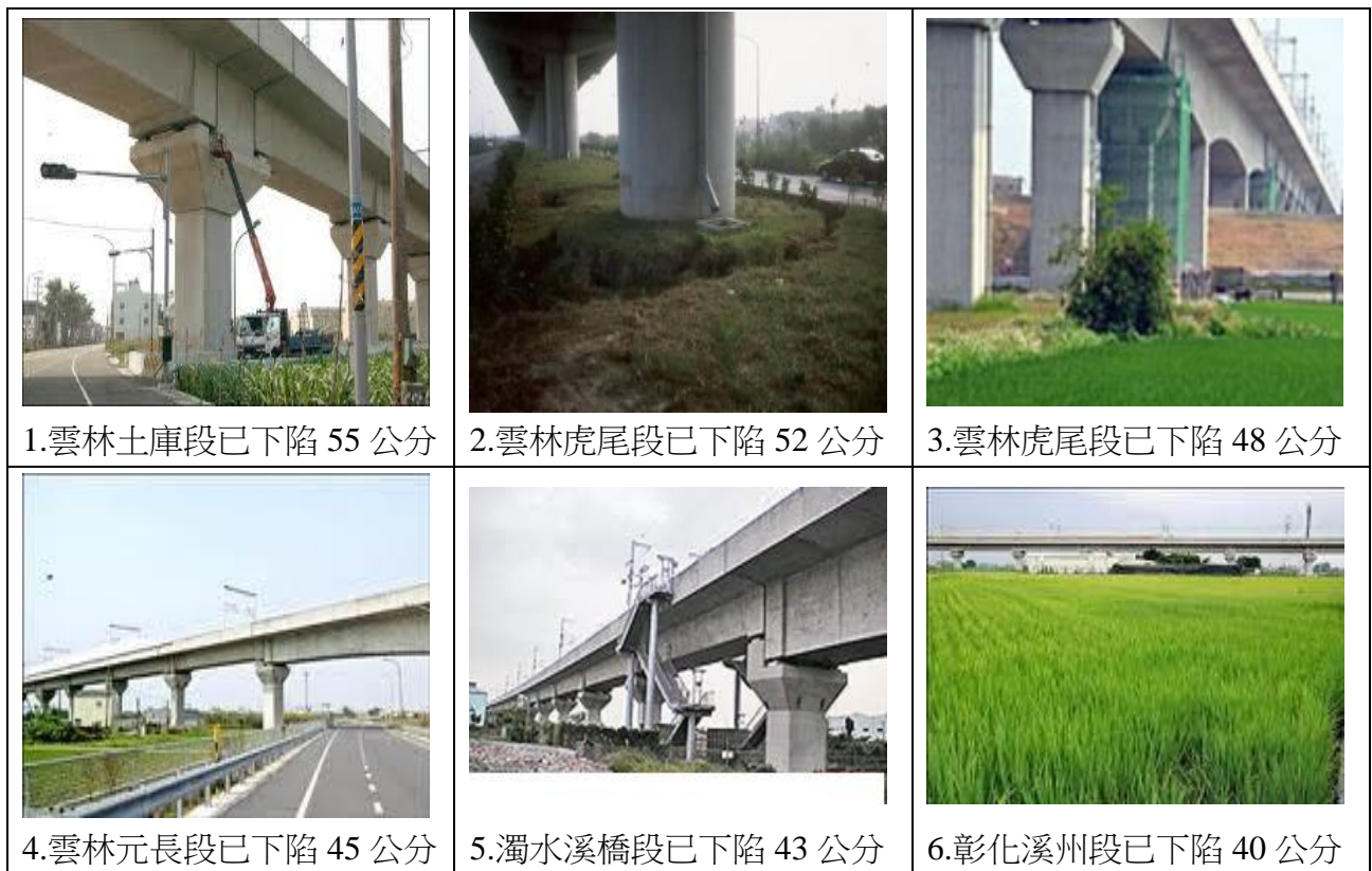
圖 5-1：高鐵雲林、彰化路段地層下陷最嚴重之橋柱（資料來源：公共工程委員會）
