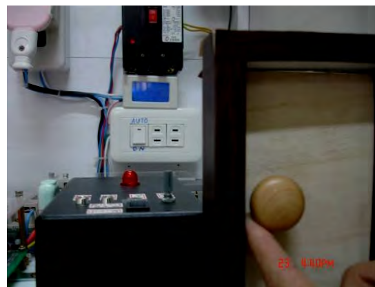
圖 4-23 關門後電燈熄滅、關閉用電
