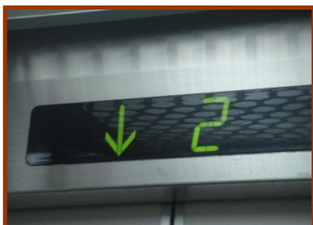
圖 17-1 住家電梯顯示樓層
