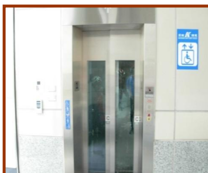
圖 17-2 中山國中捷運站電梯
