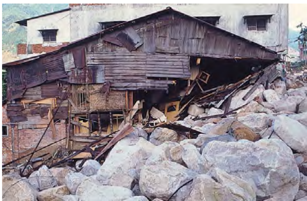
圖 77 土石流過後，受損的民宅。
