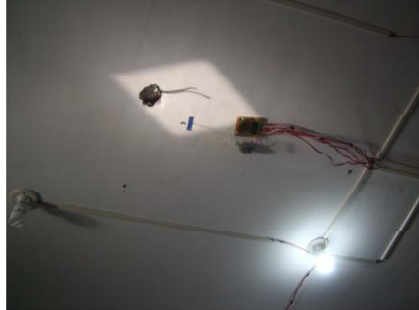
圖5-2 陽光不足時自動開啓電燈情形
