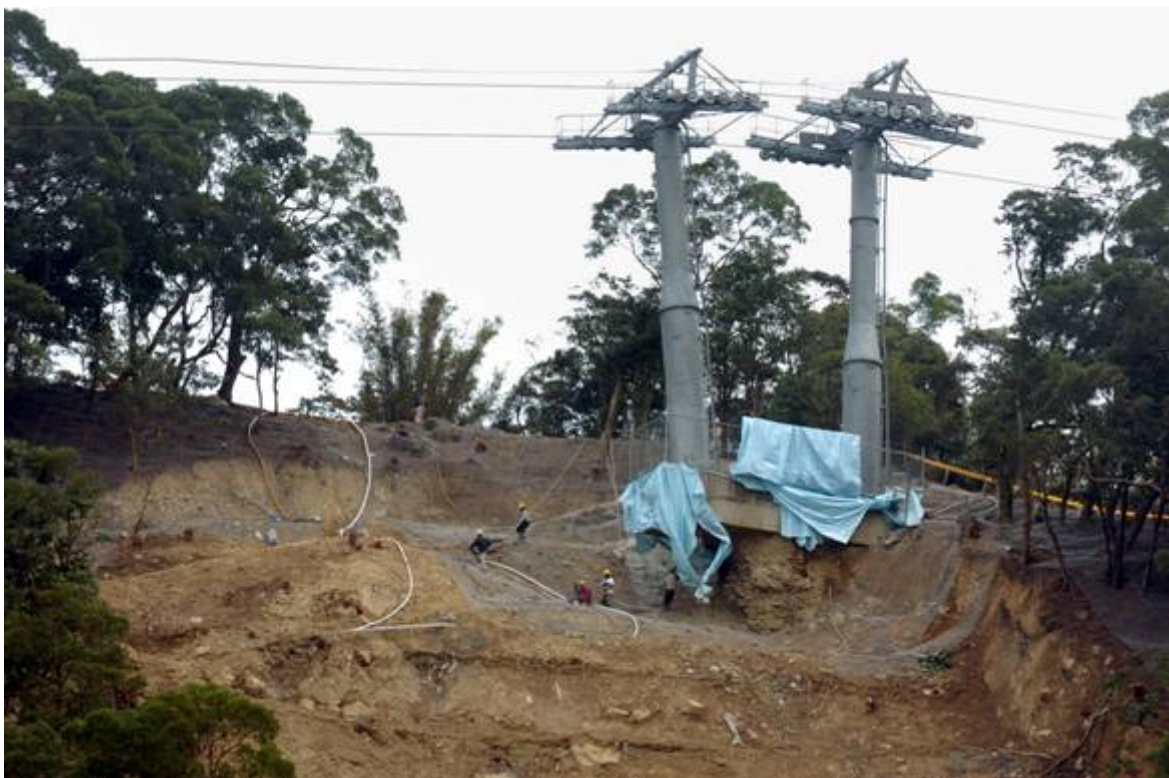
圖十五 11月8日大雨過後，邊坡之破壞延伸至坡頂 T16 塔柱，裸露之破碎地層，顯示地表下可能存在之岩層破碎帶，此與地層滑動有相互關聯性。
