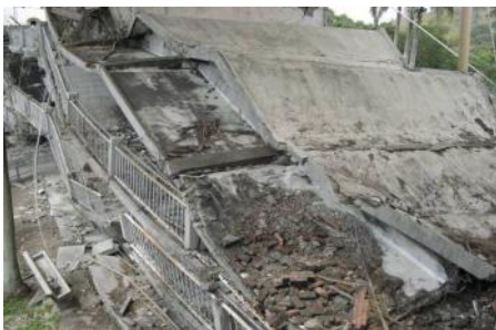
圖 37、地震造成光復國中校舍倒塌。
