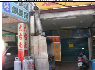
餐飲業排煙情形-1 油煙未處理直接排放於戶外
