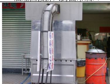
餐飲業排煙情形-2 油煙未處理直接排放於戶外
