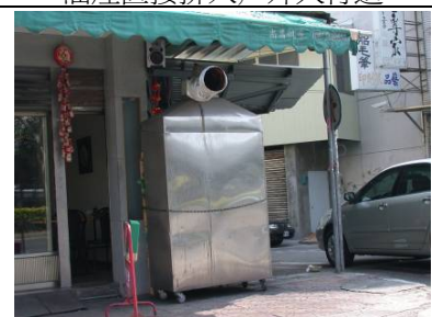
餐飲業排煙情形-3 油煙未處理直接排放於戶外
