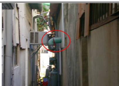
一般家庭排煙情形-2 油煙直接排入對面冷氣口
