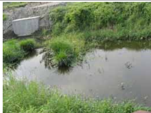
永豐餘排水施工—A1水道阻塞
