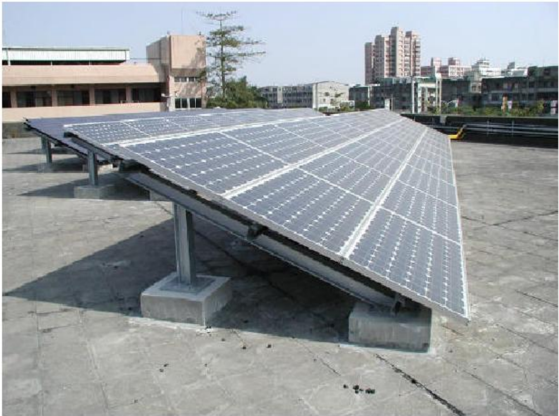
圖7：台電電力綜合研究所太陽能發電示範系統之二
