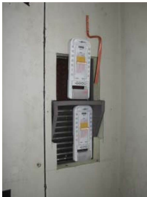
圖(十二) 水蒸發式空調機實際運轉測試圖
