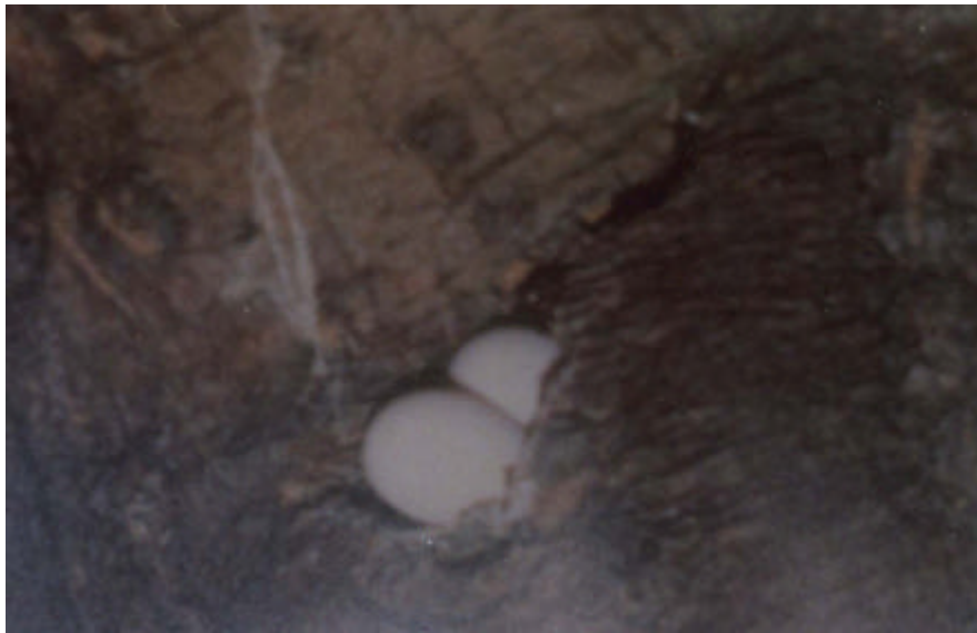
圖二：牆壁裂縫中壁虎的蛋。
