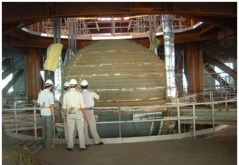
101 大樓內抗風制震大鋼球(註：摘自網站)
