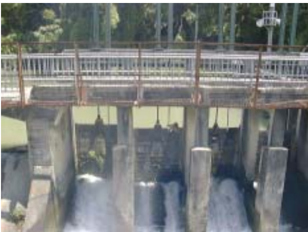
美哉！『頂角潭』的制水閘門
