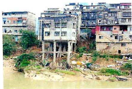
▲照片五 河川地之違規使用情形
